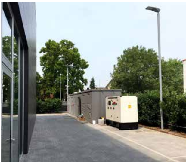
Gruppo elettrogeno da 300 kVA a supporto di un Data Center
