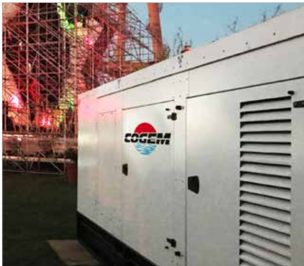
Gruppo elettrogeno da 500 kVA a supporto di un concerto
