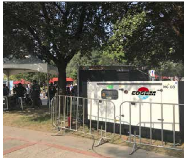
Gruppo elettrogeno da 180 kVA per gara ciclistica
