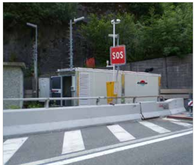
Gruppo elettrogeno da 1000 kVA su impianto autostradale
