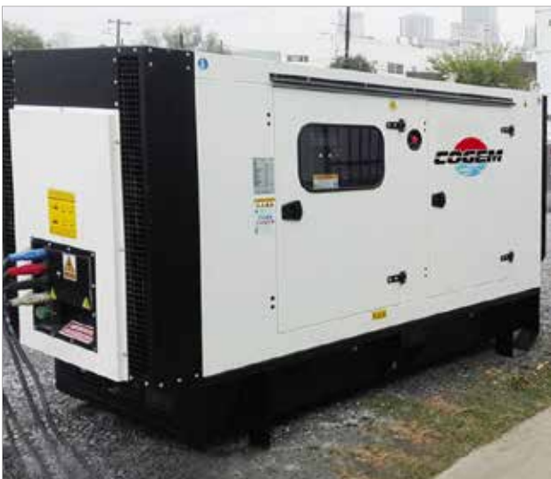
Gruppo elettrogeno da 200 kVA per impianto di refrigerazione industriale
