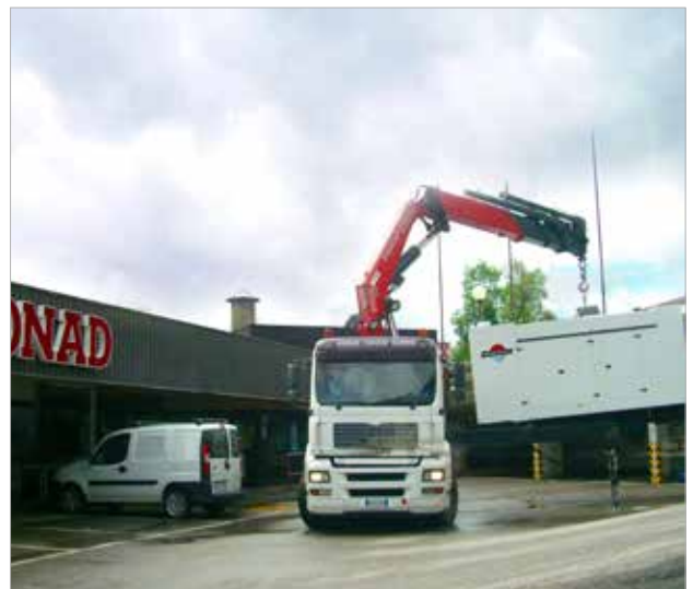
Gruppo elettrogeno da 250 kVA a supporto di un supermercato
